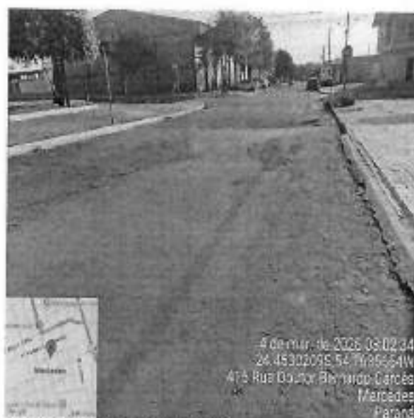
Foto 07: Ponto de remendo 03
