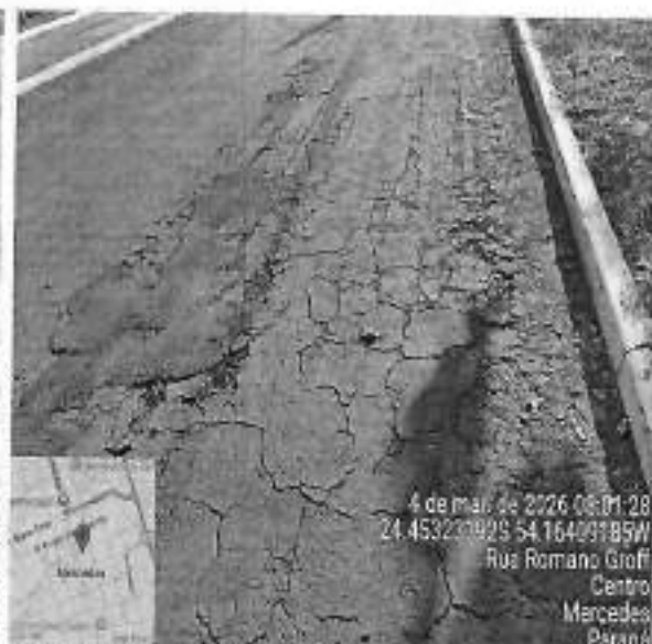
Foto 06: Ponto de remendo 02
