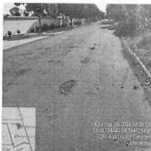
Foto 04: Ponto de remendo 05
