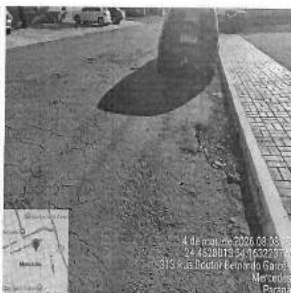
Foto 08: Ponto de remendo 04
