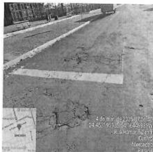
Foto 05: Ponto de remendo 01
